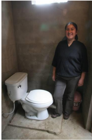
Baños rurales, con biodigestor, Cuzco, Perú
